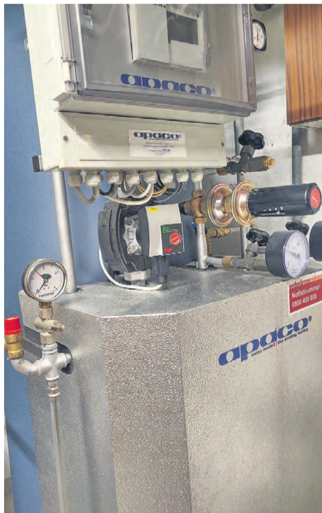
Hausinstallation für einen Wärmeverbund-Anschluss in einem Privathaus. Foto: Patrick Huber
