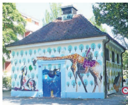
Die Street-Art Künstler CASE MAC-LAIM (Andreas von Chrzanowski) und CHROME (David Kümmin) gestalteten die IWB Trafostation an der Oberwilerstrasse.
